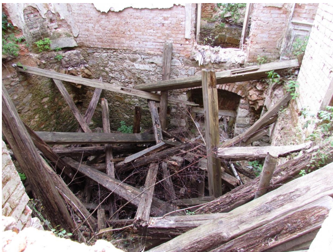
Pohled do interiérů nárožních místností středního a jižního křídla, do prostoru se stále sesouvají zbytky střešní konstrukce jižního křídla
